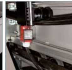
Sicherheit: dieser Sensor überwacht den Handlauf
