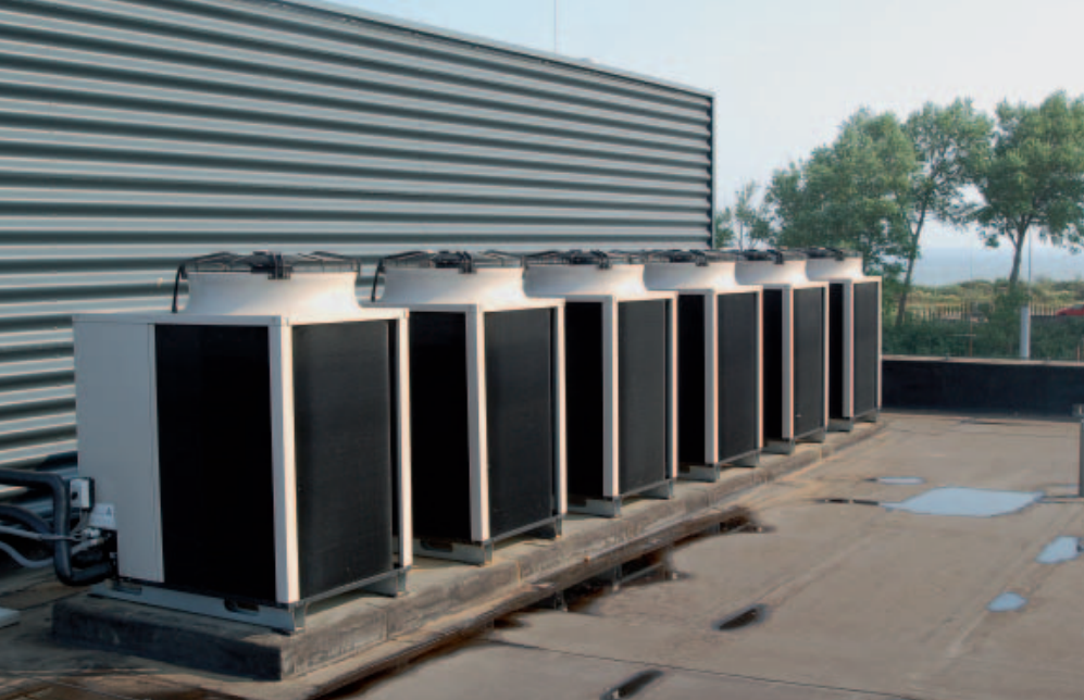
Gasabsorptiewarmtepompen in cascade-opstelling
