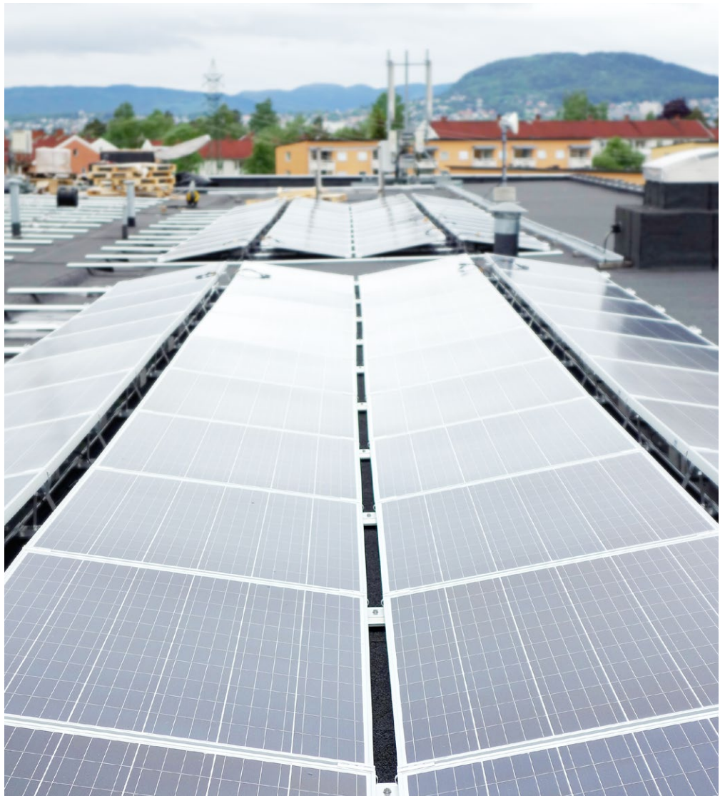
180 aurinkopaneelia asennettiin KONEen Oslon-pääkonttorin passiivenergiataloon toukokuussa 2016. Ne peittävät kolmasosan katon pinta-alasta.
